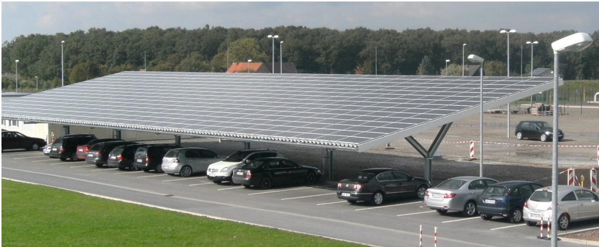
Parkplatz mit unserem SolarCarport®
